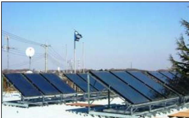
クラブハウス屋上の集熱パネル4基
